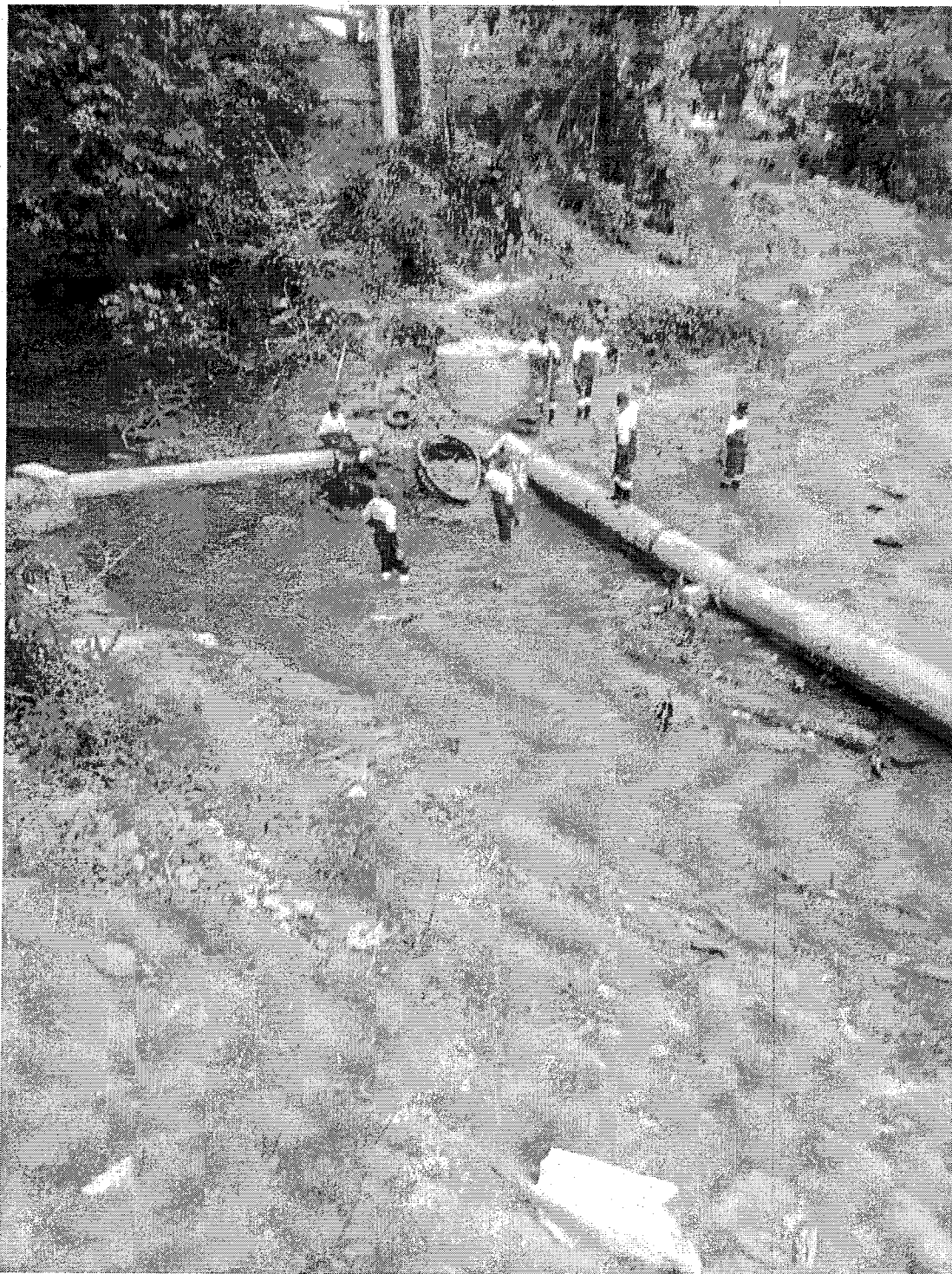
Registro Fotográfico: Trecho que compreende o bairro Coronel Borges (próximo à ETE). Detalhes da atuação da empresa terceirizada utilizando métodos e ferramentas manuais.
