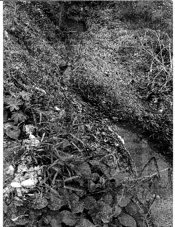
4.2 – Ponto 1: Canal de drenagem com acúmulo de sedimento e estabelecimento de vegetação, além de resíduos sólido presentes nas margens.
