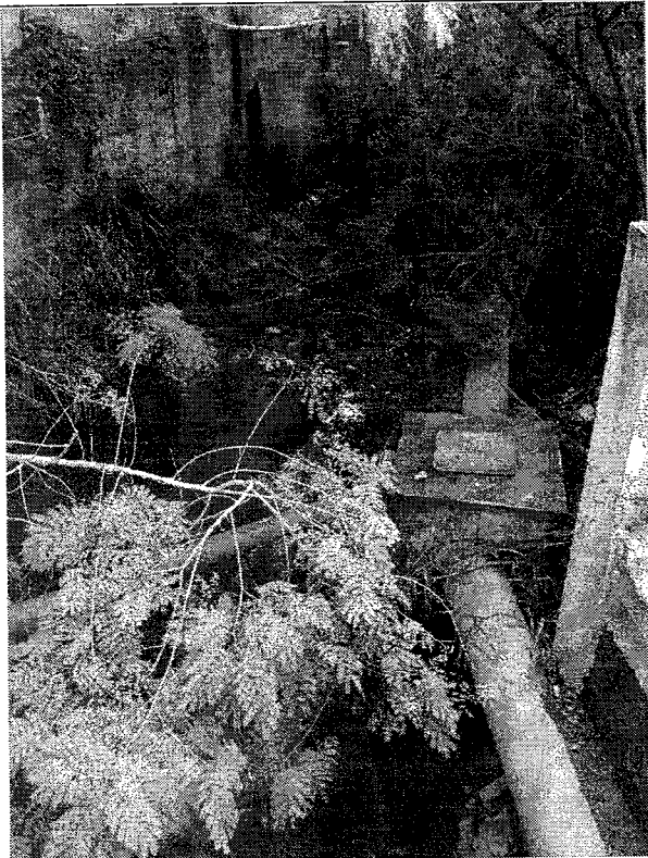
4.27 – Ponto 10: encanamento do sistema de coleta de esgoto da BRK Ambiental.
