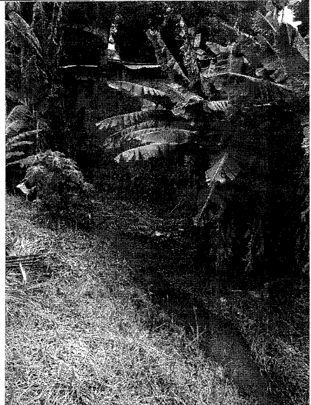
4.4 – Ponto 1: Canal de drenagem com acúmulo de sedimento e estabelecimento de vegetação, além de vegetação arbustiva-arbórea consolidada.
