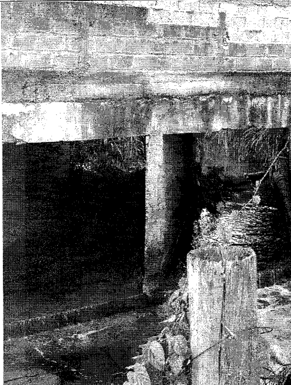
4.21 – Ponto 7: Destaque para o acúmulo de sedimento e resíduos sólido na obra de arte corrente.
