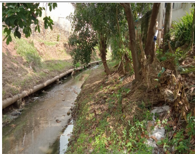
Figura 17. Trecho/Ponto 04: Água de coloração esverdeada e com odor de esgoto sanitário, bem como alguns resíduos sólidos diversos perfazendo o leito. Sugere-se limpeza manual somente.
