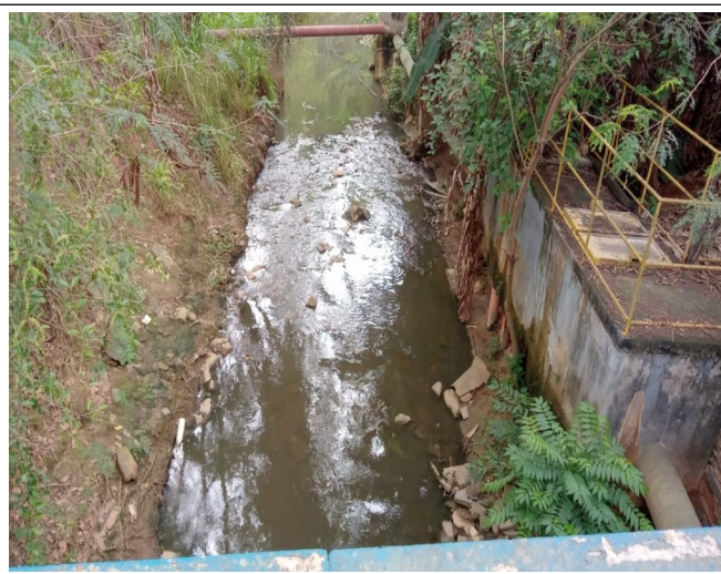
Figura 51. Trecho/Ponto 13: Água de coloração esverdeada e com odor de esgoto sanitário, bem como alguns resíduos sólidos diversos perfazendo o leito. Sugere-se limpeza manual somente.
