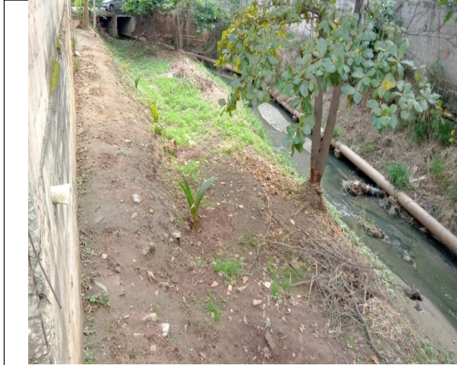
Figura 2. Trecho/Ponto 01: Água de coloração acinzentada e com muito odor de esgoto sanitário, bem como alguns resíduos sólidos diversos perfazendo o leito. Sugere-se limpeza manual somente.
