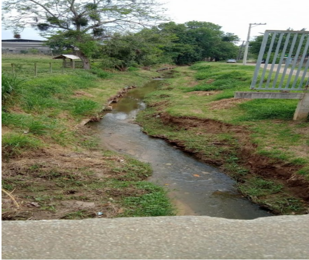
Figura 18. Trecho/Ponto 05: Água de coloração esverdeada e com odor de esgoto sanitário, bem como alguns resíduos sólidos diversos perfazendo o leito. Sugere-se limpeza manual somente.
