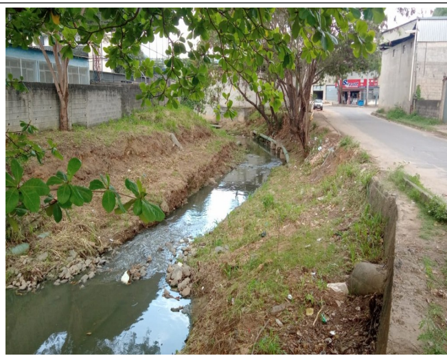
Figura 35. Trecho/Ponto 09: Água de coloração esverdeada e com muito odor de esgoto sanitário, bem como alguns resíduos sólidos diversos perfazendo o leito. Sugere-se limpeza mecanizada e manual.
