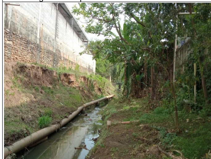
Figura 16. Trecho/Ponto 04: Água de coloração esverdeada e com odor de esgoto sanitário, bem como alguns resíduos sólidos diversos perfazendo o leito. Sugere-se limpeza manual somente.
