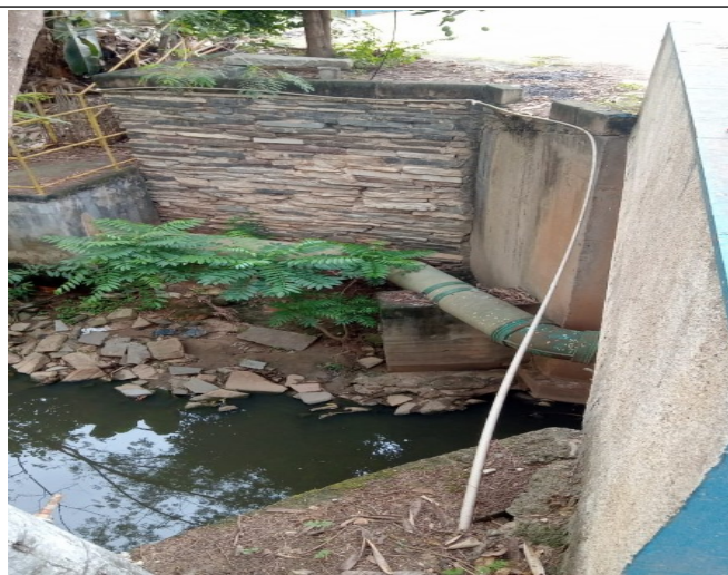
Figura 53. Trecho/Ponto 13: Água de coloração esverdeada e com odor de esgoto sanitário, bem como alguns resíduos sólidos diversos perfazendo o leito. Sugere-se limpeza manual somente.
