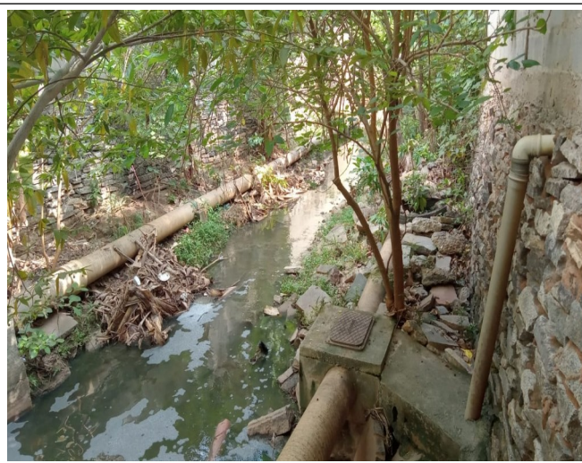
Figura 7. Trecho/Ponto 02: Água de coloração acinzentada e com odor de esgoto sanitário, bem como alguns resíduos sólidos diversos perfazendo o leito. Sugere-se limpeza manual somente.
