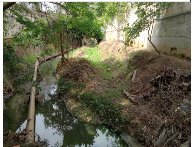
Figura 5. Trecho/Ponto 01: Água de coloração acinzentada e com muito odor de esgoto sanitário, bem como alguns resíduos sólidos diversos perfazendo o leito. Sugere-se limpeza manual somente.
