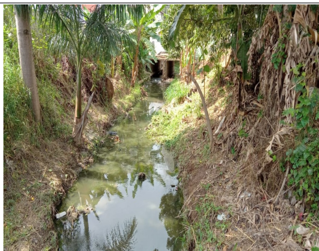
Figura 13. Trecho/Ponto 03: Água de coloração esverdeada e com odor de esgoto sanitário, bem como alguns resíduos sólidos diversos perfazendo o leito. Sugere-se limpeza manual somente.
