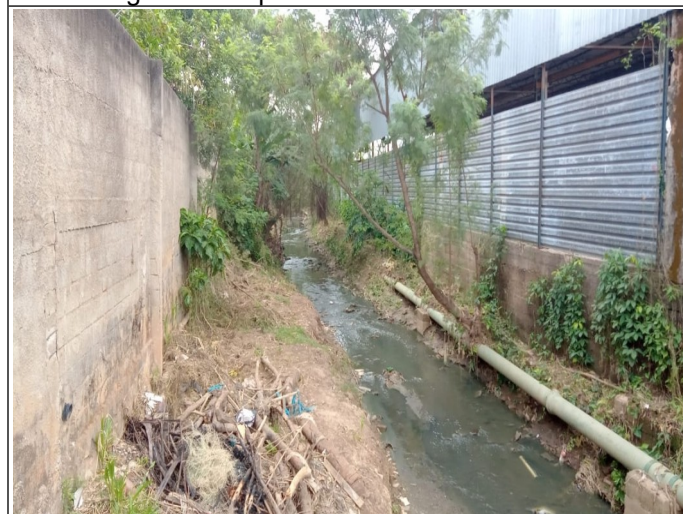
Figura 40. Trecho/Ponto 10: Água de coloração esverdeada e com odor de esgoto sanitário, bem como alguns resíduos sólidos diversos perfazendo o leito. Sugere-se limpeza manual somente.
