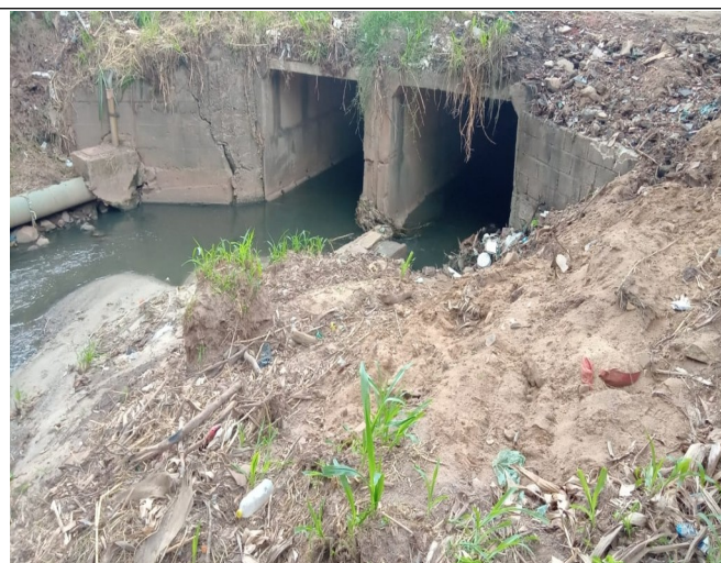
Figura 37. Trecho/Ponto 09: Água de coloração esverdeada e com muito odor de esgoto sanitário, bem como alguns resíduos sólidos diversos perfazendo o leito. Sugere-se limpeza mecanizada e manual.
