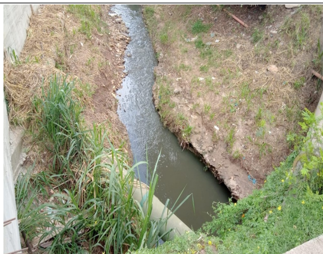
Figura 45. Trecho/Ponto 11: Água de coloração esverdeada e com odor de esgoto sanitário, bem como alguns resíduos sólidos diversos perfazendo o leito. Sugere-se limpeza manual somente.
