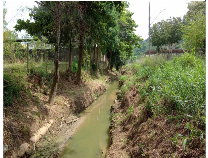
Figura 19. Trecho/Ponto 05: Água de coloração esverdeada e com odor de esgoto sanitário, bem como alguns resíduos sólidos diversos perfazendo o leito. Sugere-se limpeza manual somente.
