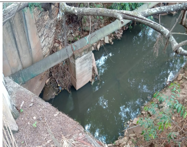
Figura 49. Trecho/Ponto 12: Água de coloração esverdeada e com odor de esgoto sanitário, bem como alguns resíduos sólidos diversos perfazendo o leito. Sugere-se limpeza manual somente.
