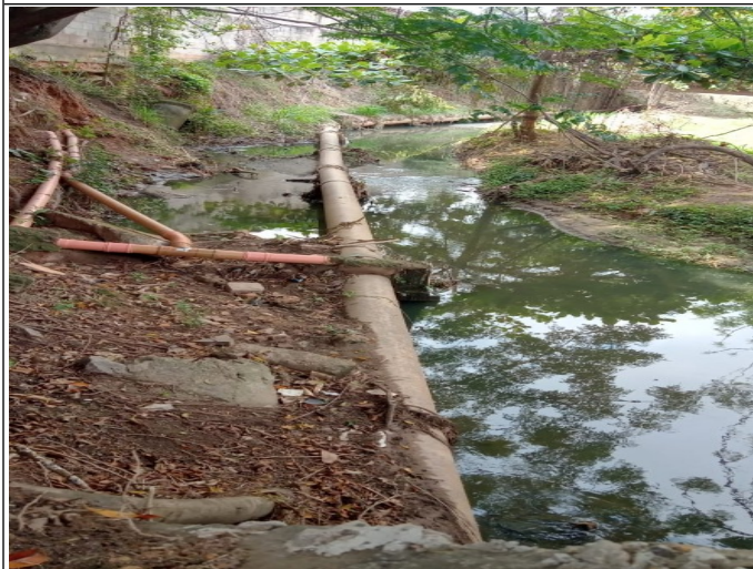
Figura 4. Trecho/Ponto 01: Água de coloração acinzentada e com muito odor de esgoto sanitário, bem como alguns resíduos sólidos diversos perfazendo o leito. Sugere-se limpeza manual somente.
