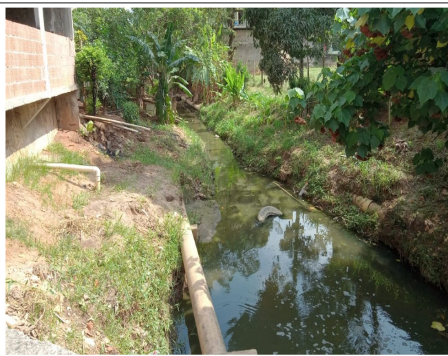
Figura 15. Trecho/Ponto 04: Água de coloração esverdeada e com odor de esgoto sanitário, bem como alguns resíduos sólidos diversos perfazendo o leito. Sugere-se limpeza manual somente.
