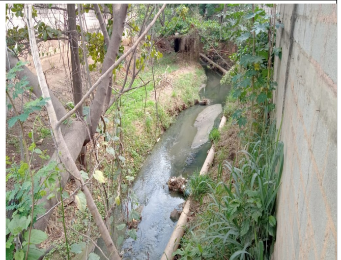
Figura 3. Trecho/Ponto 01: Água de coloração acinzentada e com muito odor de esgoto sanitário, bem como alguns resíduos sólidos diversos perfazendo o leito. Sugere-se limpeza manual somente.
