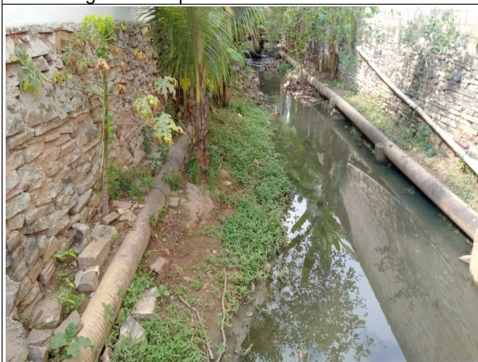
Figura 8. Trecho/Ponto 02: Água de coloração acinzentada e com odor de esgoto sanitário, bem como alguns resíduos sólidos diversos perfazendo o leito. Sugere-se limpeza manual somente.
