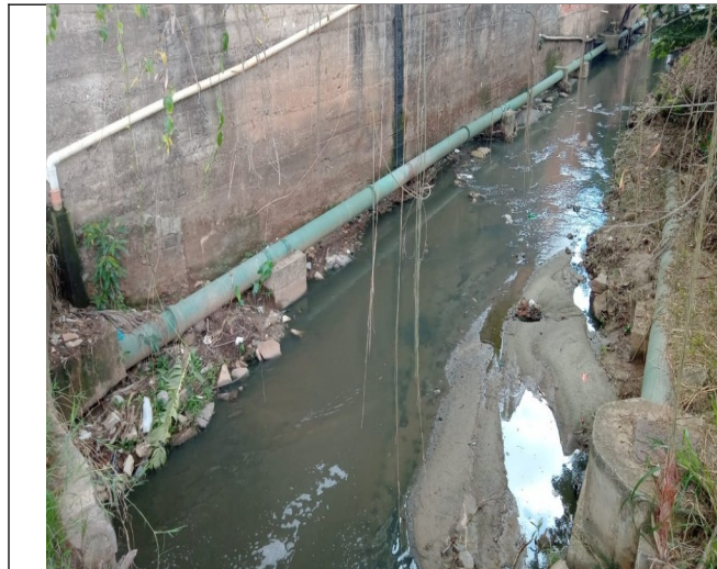
Figura 38. Trecho/Ponto 10: Água de coloração esverdeada e com odor de esgoto sanitário, bem como alguns resíduos sólidos diversos perfazendo o leito. Sugere-se limpeza manual somente.
