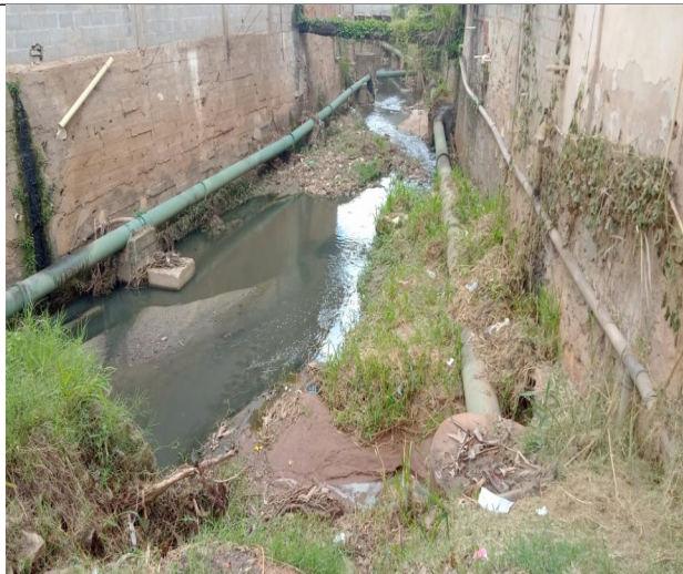
Figura 42. Trecho/Ponto 11: Água de coloração esverdeada e com odor de esgoto sanitário, bem como alguns resíduos sólidos diversos perfazendo o leito. Sugere-se limpeza manual somente.
