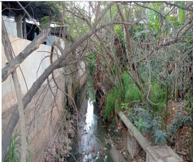
Figura 46. Trecho/Ponto 12: Água de coloração esverdeada e com odor de esgoto sanitário, bem como alguns resíduos sólidos diversos perfazendo o leito. Sugere-se limpeza manual somente.
