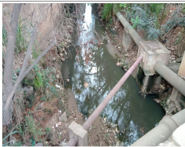
Figura 47. Trecho/Ponto 12: Água de coloração esverdeada e com odor de esgoto sanitário, bem como alguns resíduos sólidos diversos perfazendo o leito. Sugere-se limpeza manual somente.
