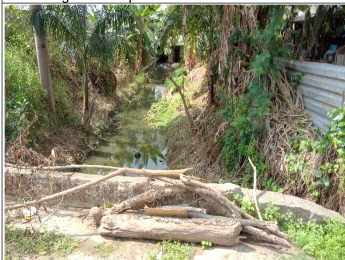
Figura 12. Trecho/Ponto 03: Água de coloração esverdeada e com odor de esgoto sanitário, bem como alguns resíduos sólidos diversos perfazendo o leito. Sugere-se limpeza manual somente.
