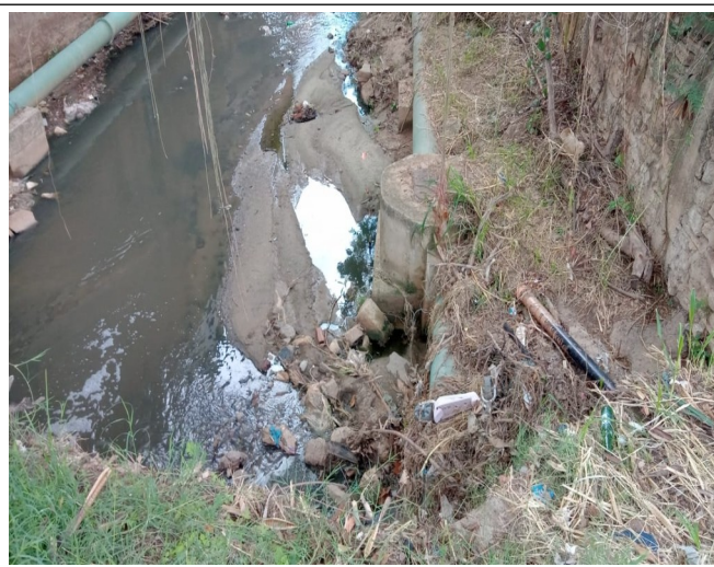
Figura 39. Trecho/Ponto 10: Água de coloração esverdeada e com odor de esgoto sanitário, bem como alguns resíduos sólidos diversos perfazendo o leito. Sugere-se limpeza manual somente.
