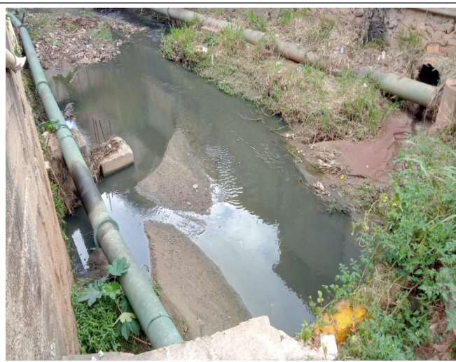
Figura 43. Trecho/Ponto 11: Água de coloração esverdeada e com odor de esgoto sanitário, bem como alguns resíduos sólidos diversos perfazendo o leito. Sugere-se limpeza manual somente.
