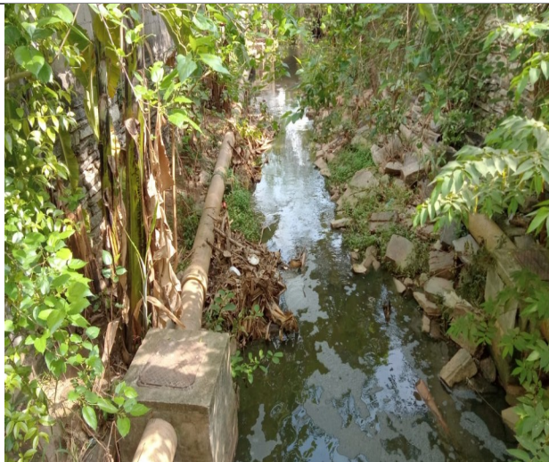
Figura 6. Trecho/Ponto 02: Água de coloração acinzentada e com odor de esgoto sanitário, bem como alguns resíduos sólidos diversos perfazendo o leito. Sugere-se limpeza manual somente.
