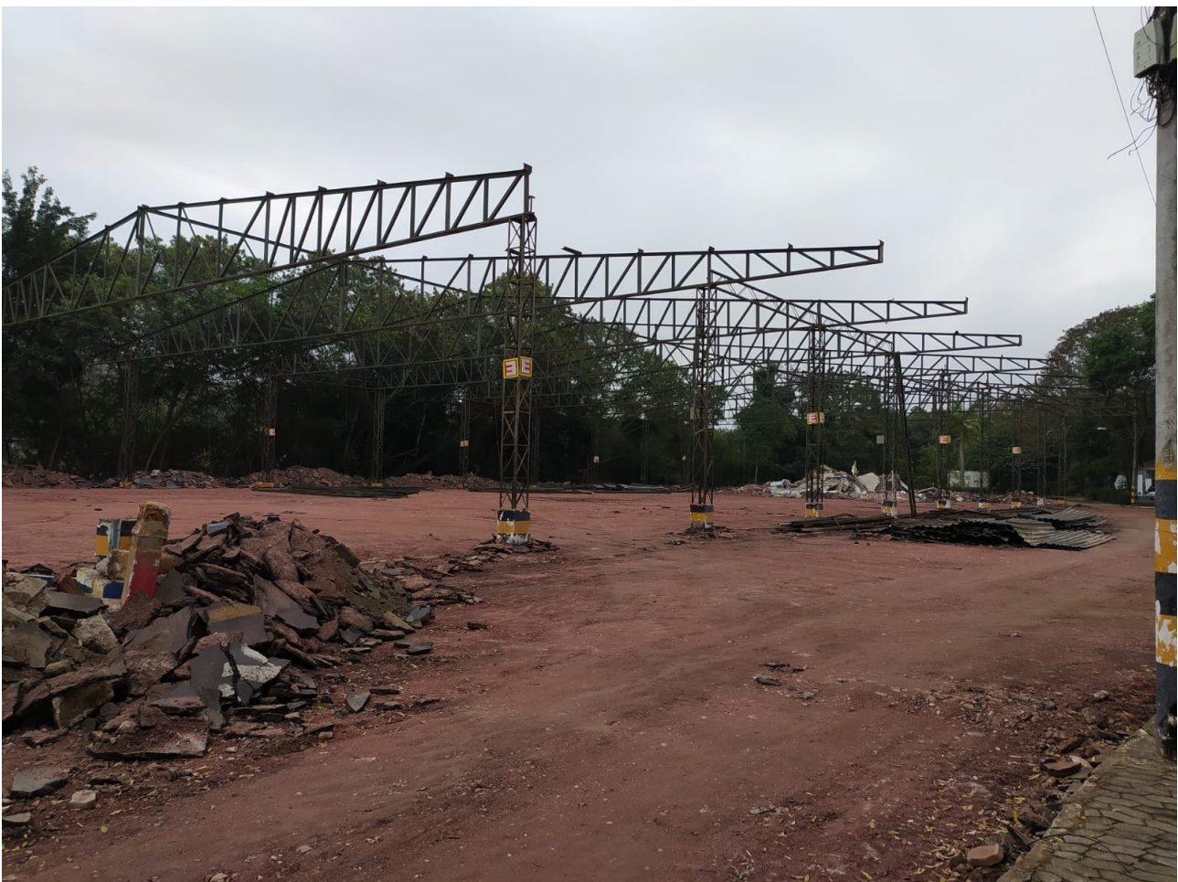
Foto 11 – Demolição de pavimento asfáltico e retirada de estrutura e acondicionamento e ordenamento das telhas.
