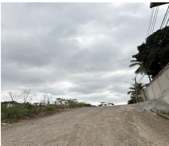
Imagem 03: Trecho da rua Cleber França sem pavimentação asfáltica.
