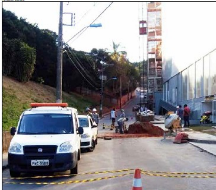
A via foi interditada e abastecimento de gás, suspenso
