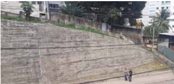
Figura 20 – Muro de Arrimo, Bairro Independência
