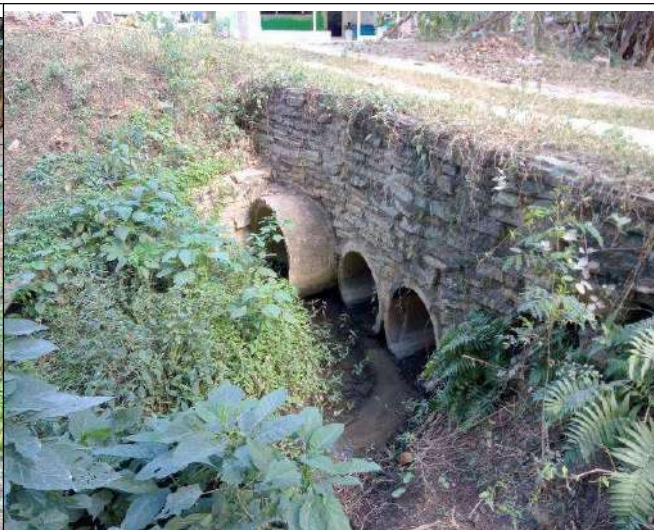
Figura 3. Perpendicular ao curso d'água, é caracterizado pela maior parte por vegetação aquática aderida a sedimento depositado na entrada de manilhamento.
