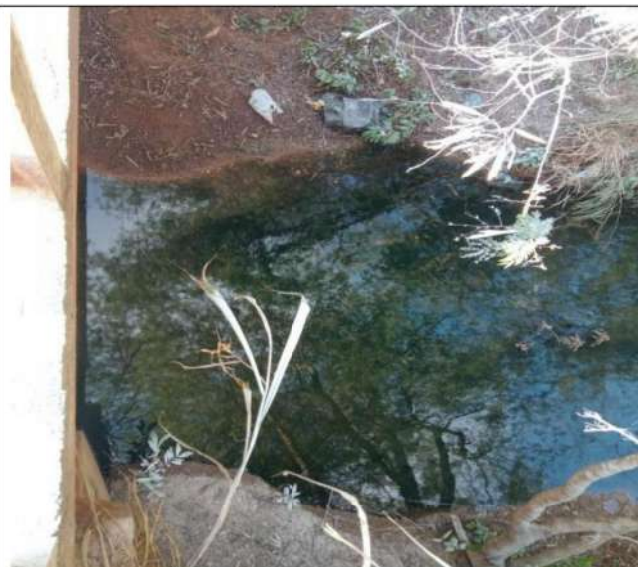
Figura 35. Perpendicular e à montante, em cota altimétrica menor: sedimentos diversos acumulados na entrada da galeria/ponte, além de água com coloração acinzentada/esverdeada com odor alterado.
