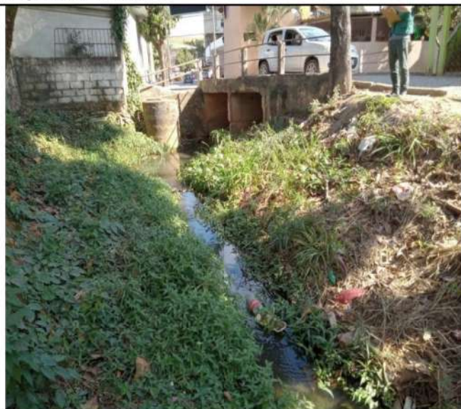
Figura 16. À jusante, água acinzentada com fluxo lento, diversos materiais sólidos dentro e à margem do leito e presença de plantas aquáticas.
