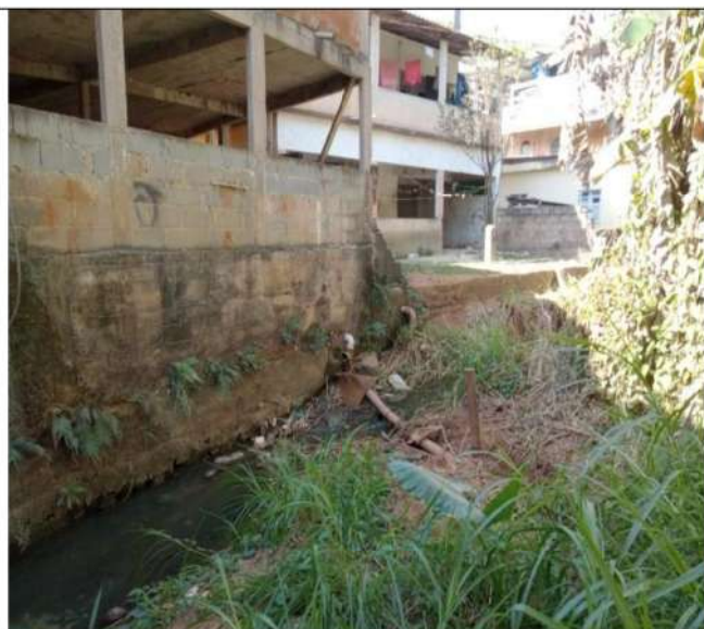
Figura 14. À montante, leito passando entre residências: muito sedimento e muita vegetação forrageira acumulada e, além de tubulação de esgotamento aberta.
