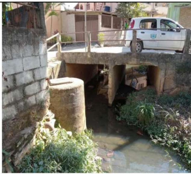
Figura 17. Outro ângulo da figura 16, mais próximo a ponte: água acinzentada e com odor e, vegetação nas extremidades do leito, além de sedimento sob o a galeria de drenagem.
