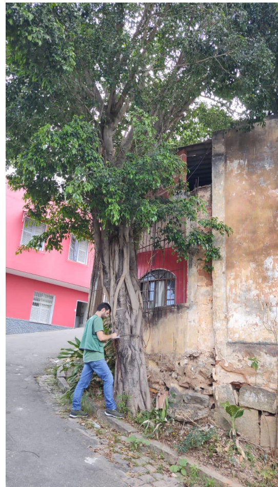
Foto 02. Árvore em conflito com elementos urbanos. Danos na estrutura do imóvel.
