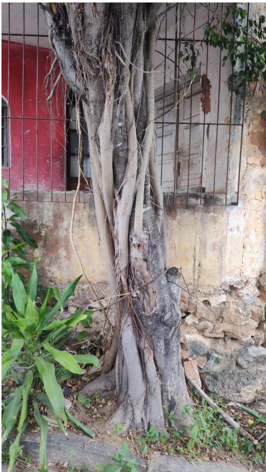
Foto 01. Árvore em conflito com os elementos urbanos. Danos na estrutura do imóvel.
