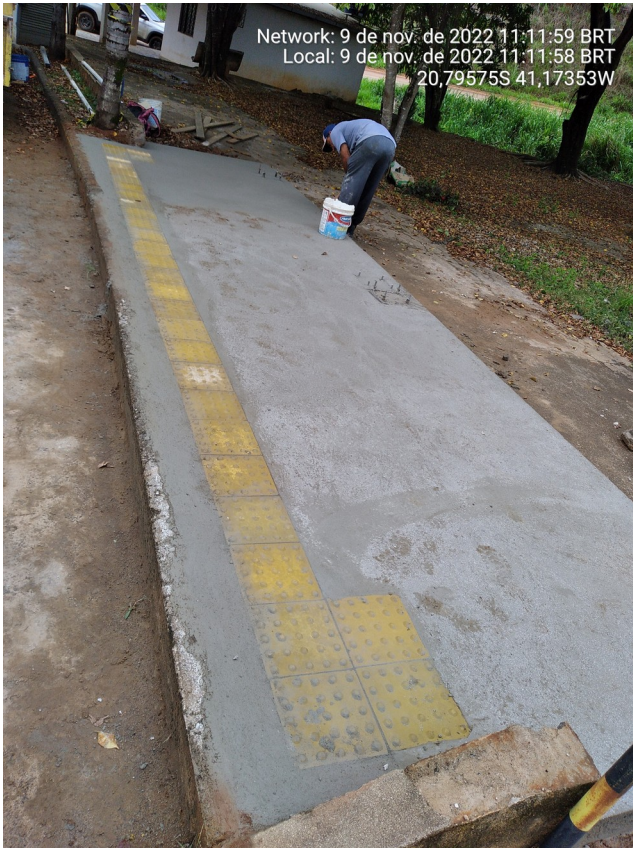
Figura 5 - Acabamento da implantação da calçada. (10 m comprimento x 2,1 m largura) (Qde: 2,0 und. de calçada).
