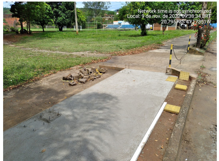
Figura 4: Implantação da calçada com piso tátil juntamente com a fundação convencional para abrigo duplo.
