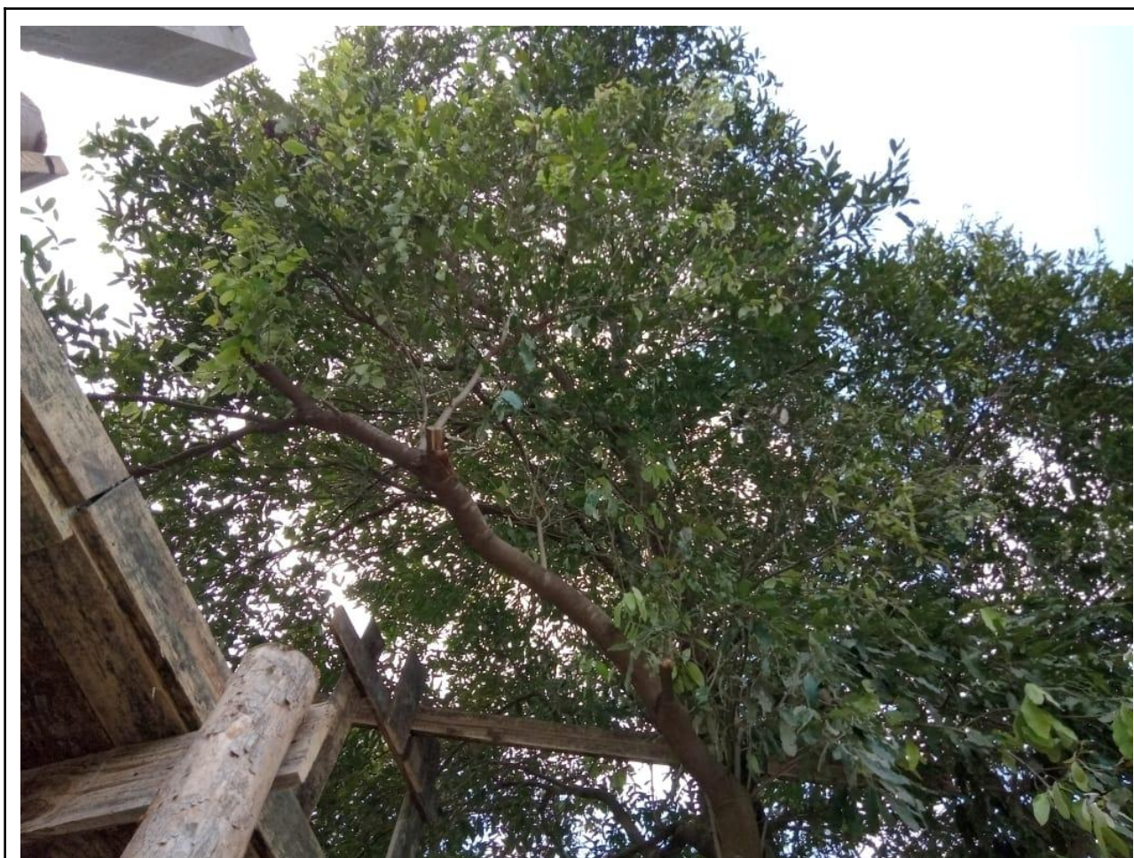
5.4. Galhos da árvore em direção à residência (em reforma/construção).
