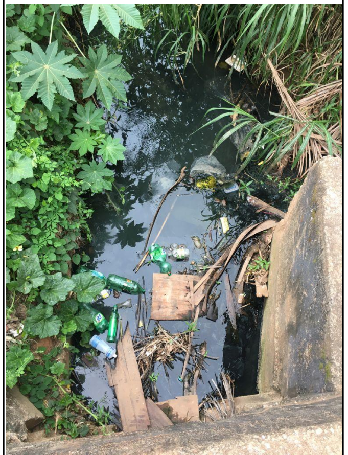
Figura 11. Obras de arte com acúmulo de resíduos vegetais, lixo e vegetação gramínea, herbácea e aquática. Água com coloração escura/acinzentada e com mau cheiro. Próximo da Rua João Barbosa, Bairro Nossa Senhora Aparecida.
