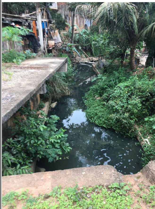
Figura 13. Obras de arte com acúmulo de resíduos vegetais, lixo e vegetação gramínea, herbácea e aquática. Água com coloração escura/acinzentada e com mau cheiro. Próximo da Rua João Barbosa, Bairro Nossa Senhora Aparecida.
