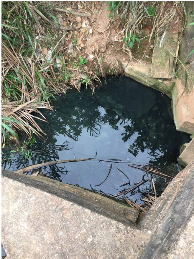
Figura 10. Obras de arte com acúmulo de resíduos vegetais, lixo e vegetação gramínea, herbácea e aquática. Água com coloração escura/acinzentada e com mau cheiro. Próximo da Rua João Barbosa, Bairro Nossa Senhora Aparecida.
