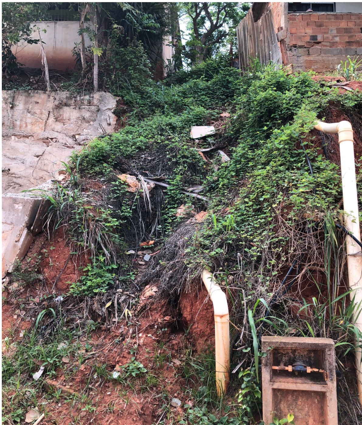
PARTE QUE FALTA O PEDAÇO DA ESCADA
